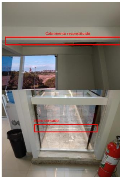
Figura 06: Trinca horizontal em vidro localizado no prédio principal da Câmara Municipal de Macaé-RJ. Ponto 2, Fonte: Arquivo particular, SENCO, 2019.
