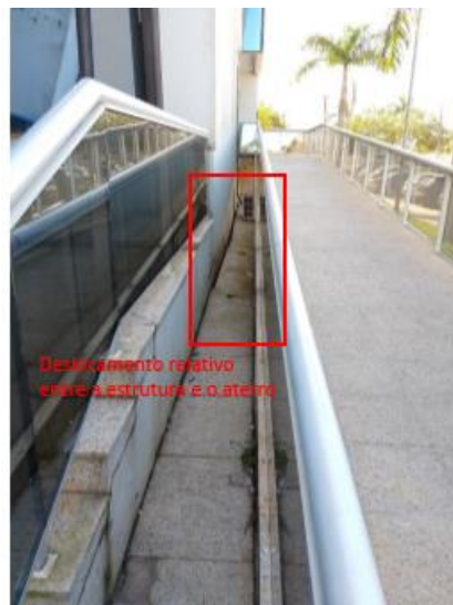
Figura 08: Deslocamento relativo de pavimento em granito da área externa do prédio principal da Câmara Municipal de Macaé-RJ. Ponto 3b, Fonte: Arquivo particular, SENCO, 2019.
