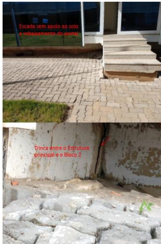
Figura 18 e 19: Trinca entre o bloco anexo 2 e o prédio principal e recalque do solo em relação a escada de acesso ao bloco 02 da Câmara Municipal de Macaé-RJ. Ponto 6a e b, Fonte: Arquivo particular, SENCO, 2019.
