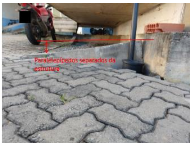
Figura 26: Recalque de solo no prédio dos motoristas da Câmara Municipal de Macaé-RJ. Ponto 9 a, Fonte: Arquivo particular, SENCO, 2019.
