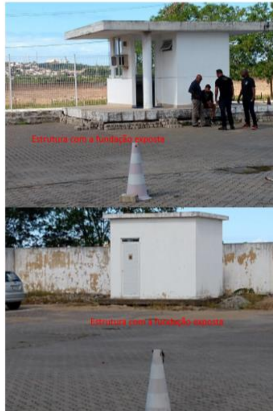
Figura 16 e 17: Recalque de solo em relação as estruturas da guarita e da cabine de medição da Câmara Municipal de Macaé-RJ. Ponto 5c e d, Fonte: Arquivo particular, SENCO, 2019.
