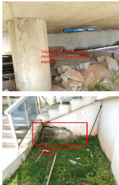
Figura 28 e 29: Avarias nos elementos de acesso ao prédio anexo 3 da Câmara Municipal de Macaé-RJ. Ponto 10 a e b, Fonte: Arquivo particular, SENCO, 2019.
