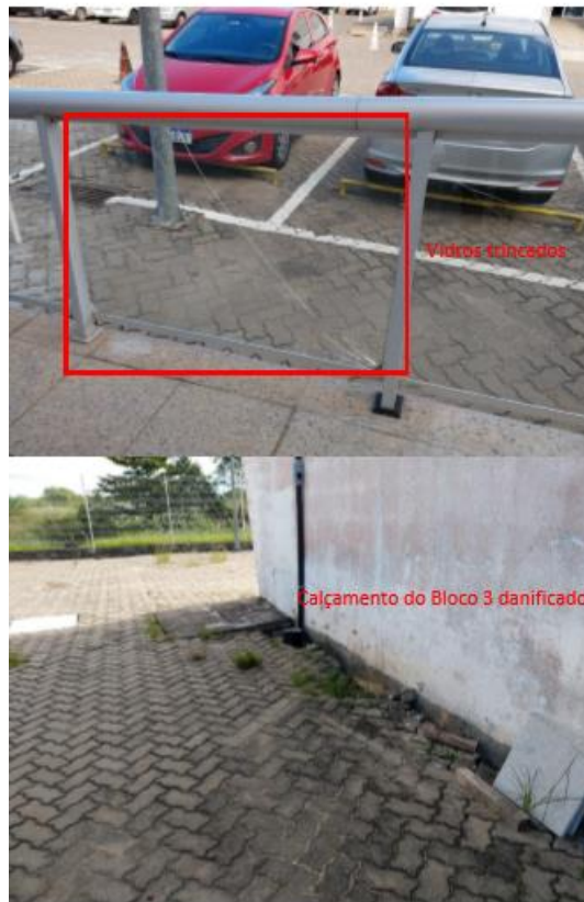
Figura 21 e 22: Trinca no vidro do guarda corpo da rampa de acesso e Recalque entre o solo e o bloco anexo 3 da Câmara Municipal de Macaé-RJ. Ponto 6c, Fonte: Arquivo particular, SENCO, 2019.
