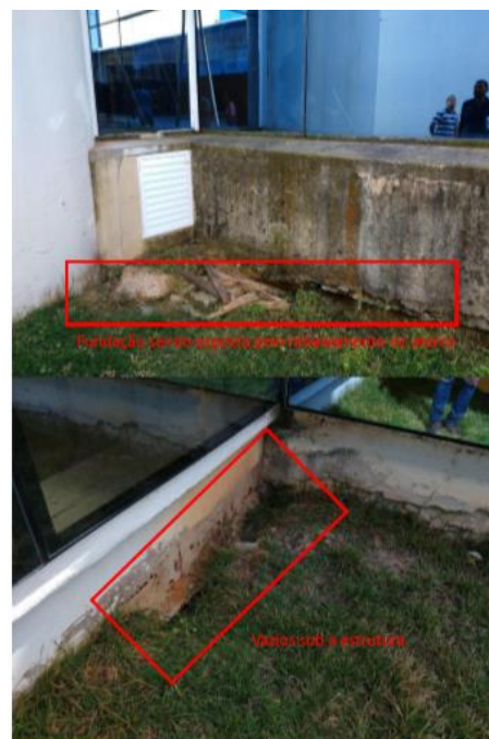
Figura 30 e 31: Recalque do solo em relação ao prédio anexo 3 da Câmara Municipal de Macaé-RJ. Ponto 11 a e b, Fonte: Arquivo particular, SENCO, 2019.
