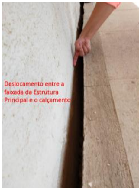
Figura 35: Deslocamento do calçamento em relação ao prédio principal da Câmara Municipal de Macaé-RJ. Ponto 12 d, Fonte: Arquivo particular, SENCO, 2019.
