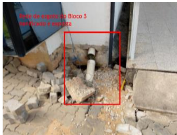
Figura 23: Avarias no sistema de esgotamento sanitário do prédio dos motoristas da Câmara Municipal de Macaé-RJ. Ponto 7c, Fonte: Arquivo particular, SENCO, 2019.
