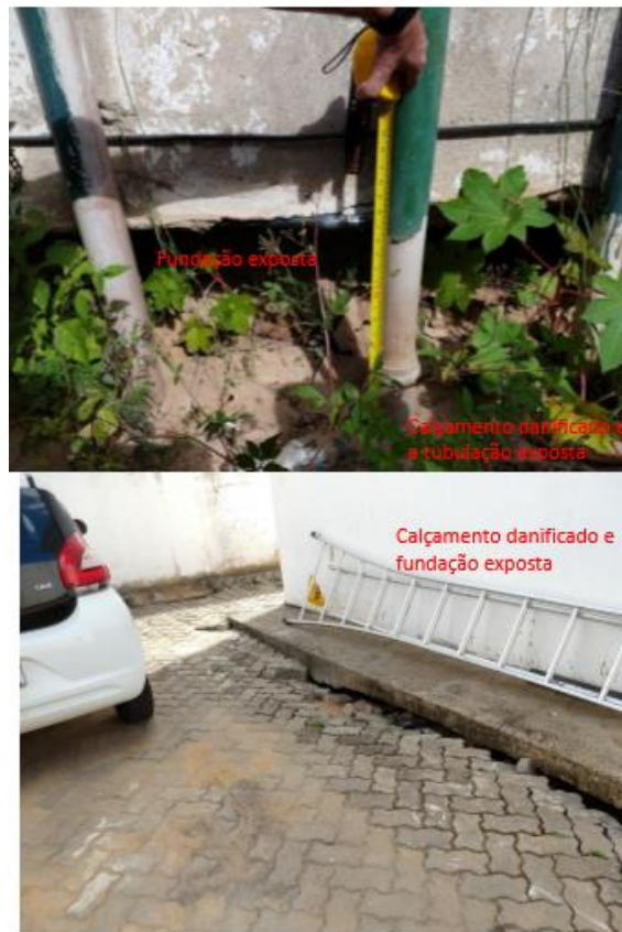
Figura 24: recalque de solo no prédio dos motoristas e na subestação da Câmara Municipal de Macaé-RJ. Ponto 8 a e b, Fonte: Arquivo particular, SENCO, 2019.
