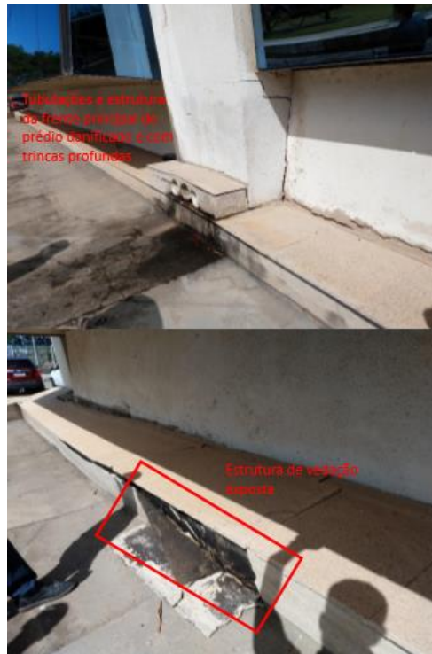
Figura 34: Recalque do solo em relação ao prédio principal da Câmara Municipal de Macaé-RJ. Ponto 12 b e c, Fonte: Arquivo particular, SENCO, 2019.
