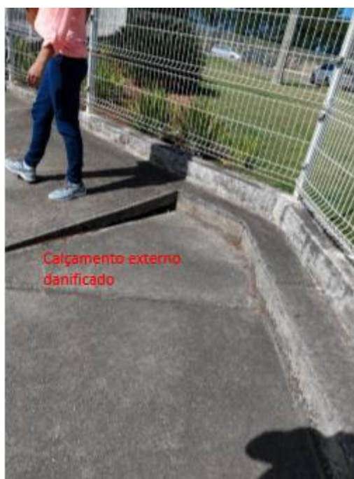
Figura 36: Recalque do calçamento em relação a grade externa da Câmara Municipal de Macaé-RJ. Ponto 12 e, Fonte: Arquivo particular, SENCO, 2019.
