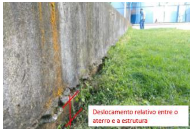
Figura 32: Recalque do solo em relação ao prédio anexo 3 da Câmara Municipal de Macaé-RJ. Ponto 11 c, Fonte: Arquivo particular, SENCO, 2019.
