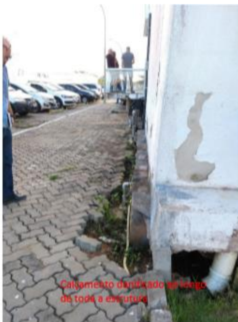
Figura 13 e 14: Avarias na pavimentação da área externa do prédio principal da Câmara Municipal de Macaé-RJ. Ponto 5a, Fonte: Arquivo particular, SENCO, 2019.
