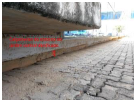
Figura 20: Recalque entre o solo e o bloco anexo 2 da Câmara Municipal de Macaé-RJ. Ponto 6c, Fonte: Arquivo particular, SENCO, 2019.
