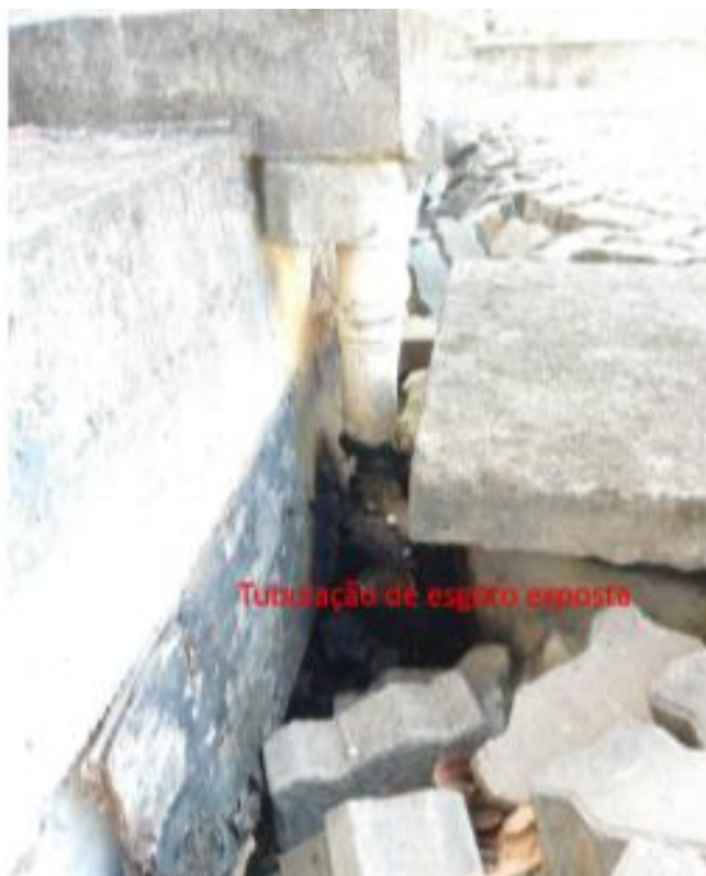
Figura 27: Avarias na rede de esgoto do prédio dos motoristas da Câmara Municipal de Macaé-RJ. Ponto 9 b, Fonte: Arquivo particular, SENCO, 2019.
