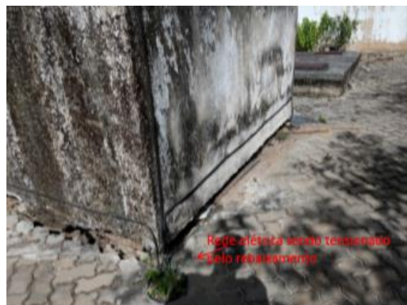
Figura 25: Recalque de solo no castelo d'água da Câmara Municipal de Macaé-RJ. Ponto 8 c, Fonte: Arquivo particular, SENCO, 2019.
