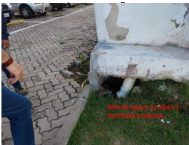
Figura 15: Avarias na rede de esgoto, área externa do prédio principal da Câmara Municipal de Macaé-RJ. Ponto 5b, Fonte: Arquivo particular, SENCO, 2019.
