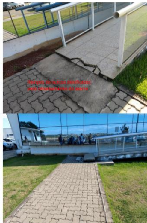
Figura 11 e 12: Deslocamento do aterro em relação aos elementos (rampa) do prédio principal da Câmara Municipal de Macaé-RJ. Ponto 4b, Fonte: Arquivo particular, SENCO, 2019.
